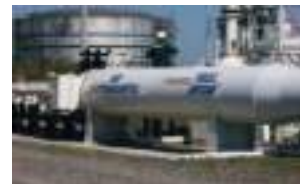
Іл. 43.11. Нафтоперекачувальна станція (Одеса – Броди)
